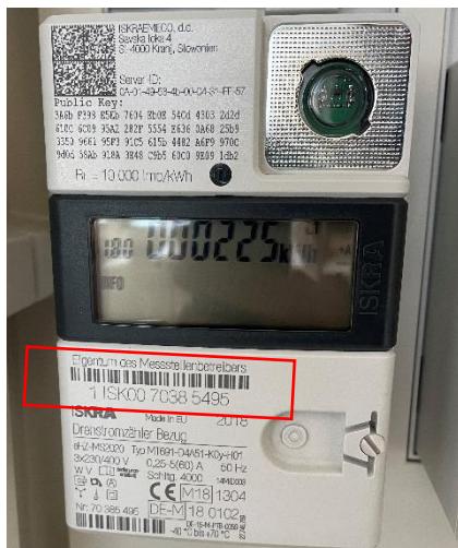
Zähler mit Zählernummer
